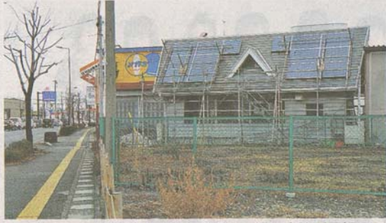
国道19号沿いの村山自動車ボデー工場の事務所屋根に設置した太陽光パネル
